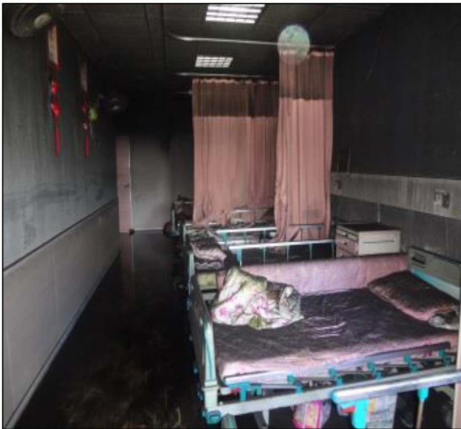
防火區劃起火側 起火區之住房
